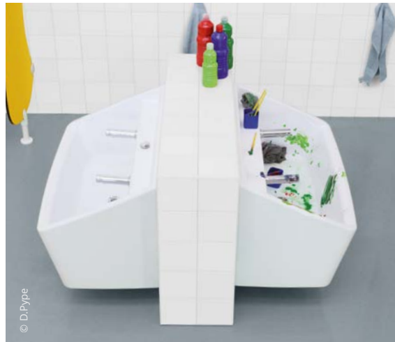
Vidage avec trop plein pour des jeux d'eau sans danger
